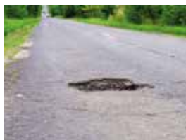
La vulnérabilité des infrastructures dépend notamment de leur état
